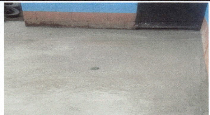
Foto 4: Torta de piso remoliado frente de los baños
